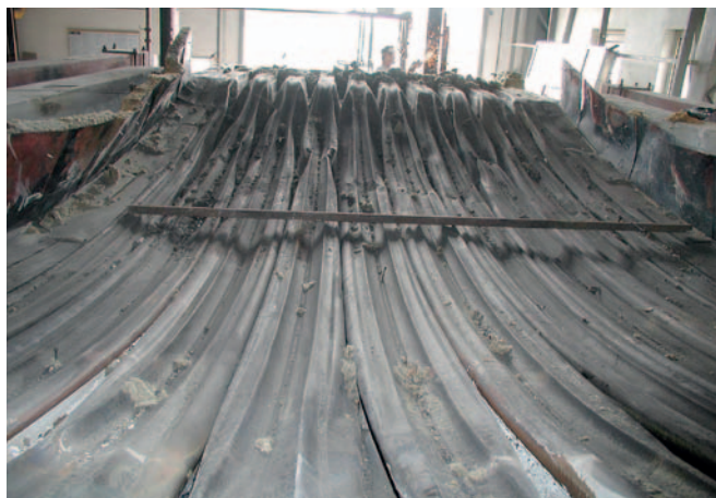
Obr. 1 – Trapézový plech TR 160 po požáru
